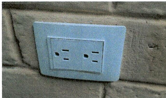
Foto 10: sistema eléctrico instalado
